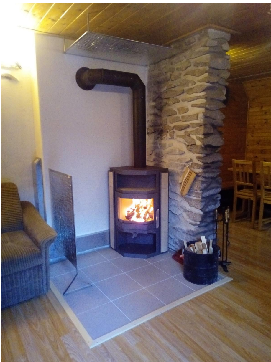
Místo krbu, který nevyhovoval dostatečným teplem a spotřebou, jsou nová krbová kamna s vysokou účinností.
